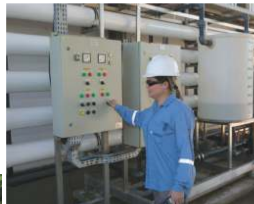
COLABORADORA UVS ESSENCIS - TRATAMENTO DE EFLUENTES
